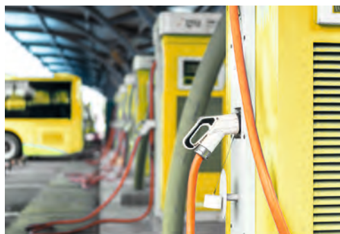
Laden von Linienbussen im Betriebshof.
